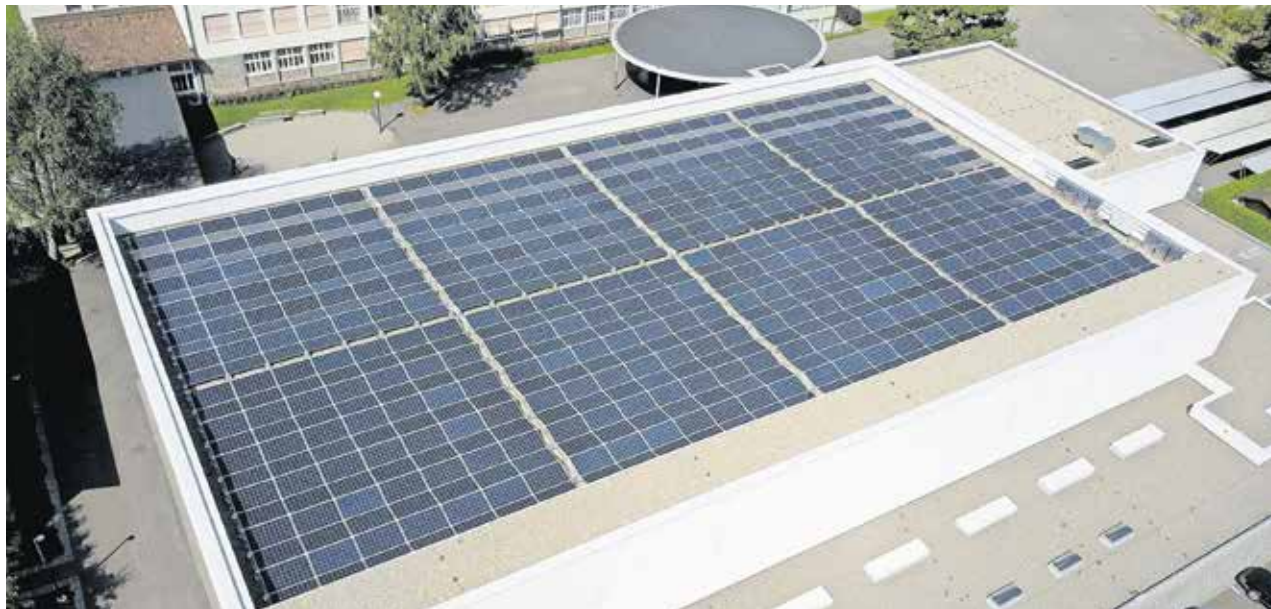
Eine grosse Fotovoltaikanlage auf dem Dach der neuen Turnhalle und Aula Hagen liefert sauberen Solarstrom: Damit wird das Schulareal Hagen/Feldli mittels Grundwasser-Wärmepumpe erneuerbar beheizt. FOTO: ZVG
