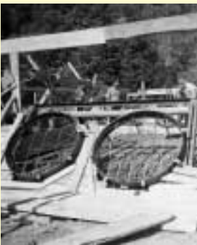
Die Seilverankerung in der Talstation
